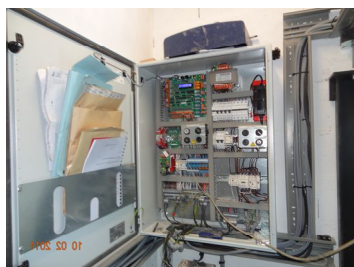
Armoire de manœuvre
