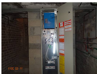
Armoire de manœuvre
