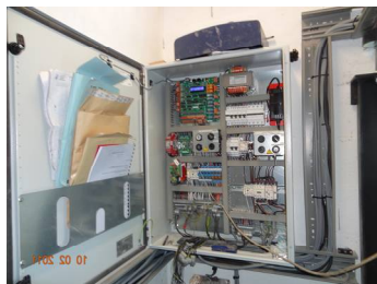
Armoire de manœuvre
